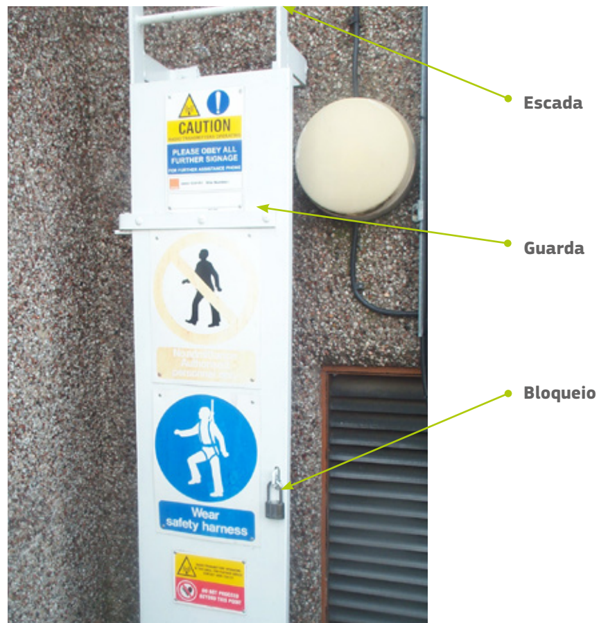
Figura 9.2 — Utilização de guarda para escada para restringir o acesso a campos fortes num telhado
