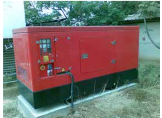
Tenete i gruppi elettrogeni in buone condizioni.
