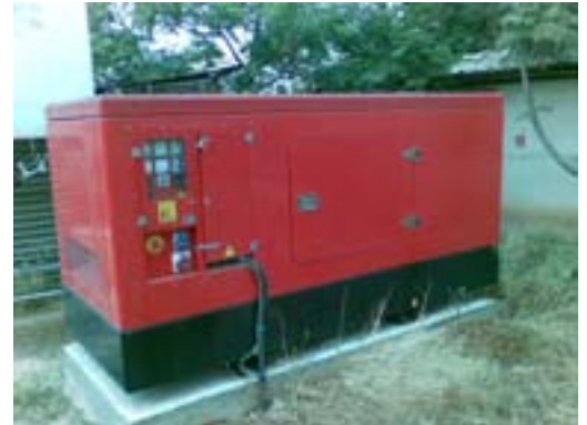
Maintenez les générateurs en bon état.
