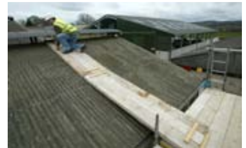
Utilisez des planches pour marcher sur les toits fragiles.
