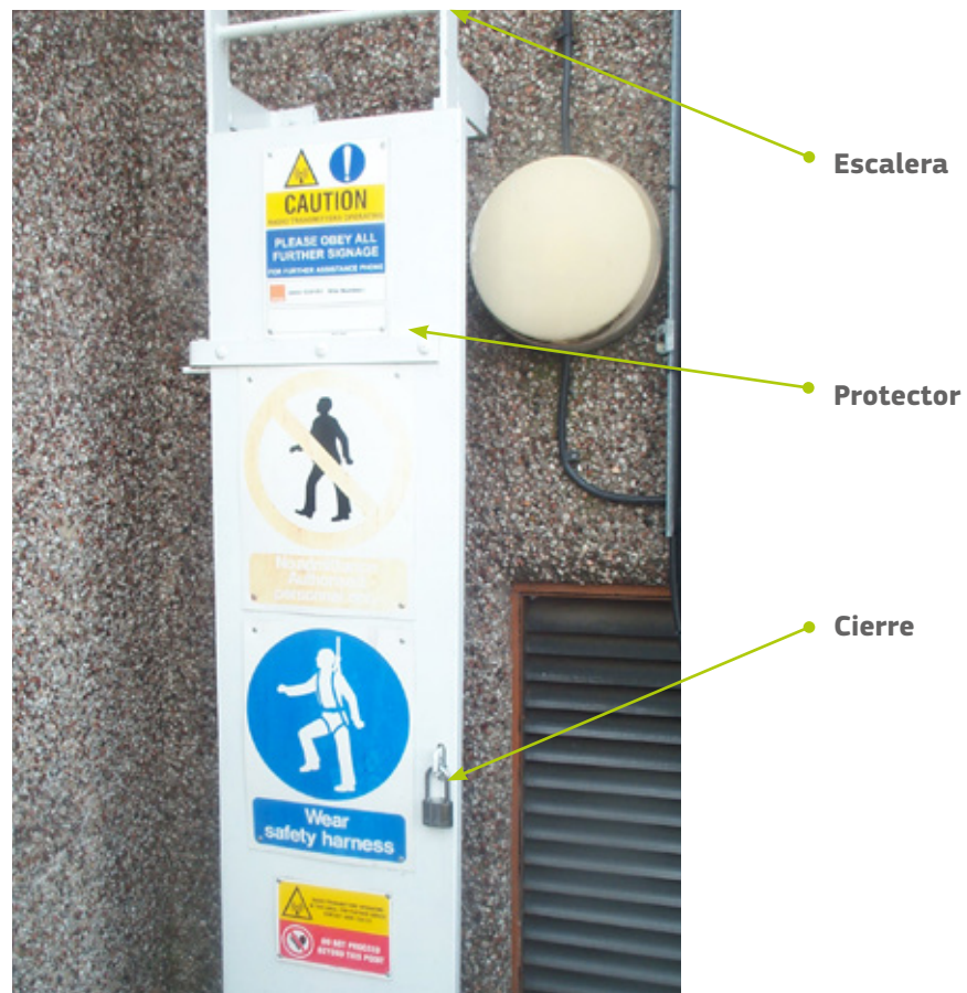
Figura 9.2. Uso de un protector de escalera para restringir el acceso a campos intensos en una azotea
